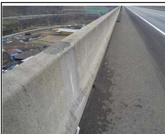
상행선 S12 균열 및 백태
